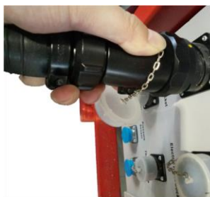
Conexão do cabo com a caixa elétrica aquecimento
